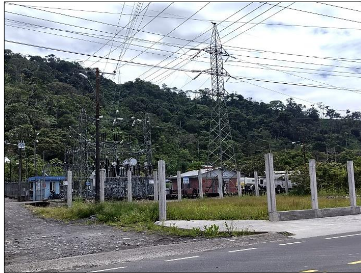
Foto 30: Subestación de energía eléctrica.
